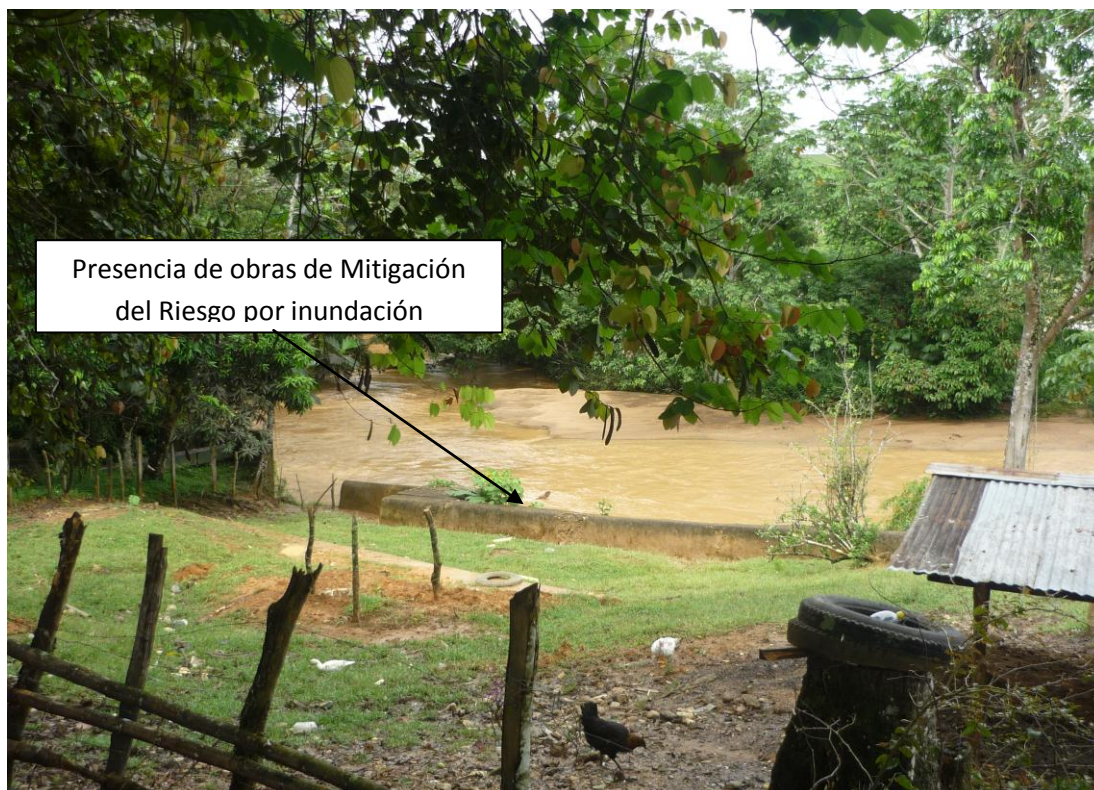
Zona 2. Esta área aparece en el plano como zona de inundación, pero ya existe un control adecuado para la amenaza. Se presenta igualmente la amenaza por deslizamiento.
